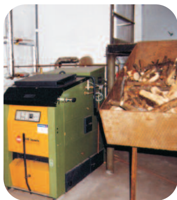
Stückholzheizung mit manueller Nachfüllung.
